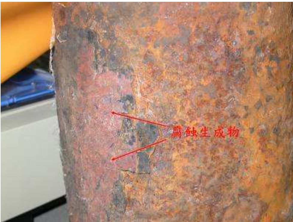
圖 3 製程管線外部遭受腐蝕而嚴重減薄
