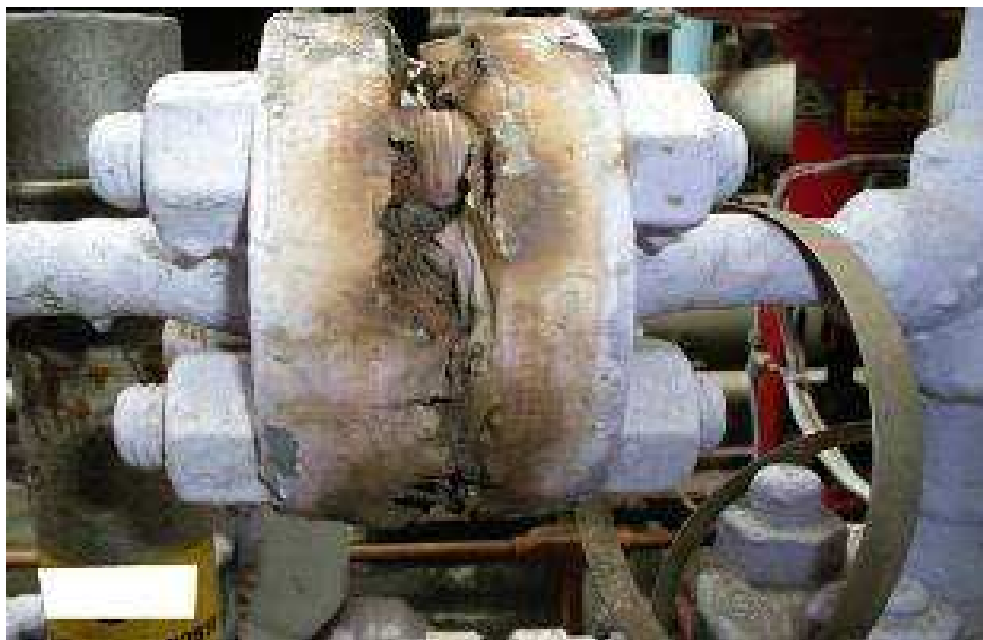
圖 6 管線法蘭接面腐蝕
