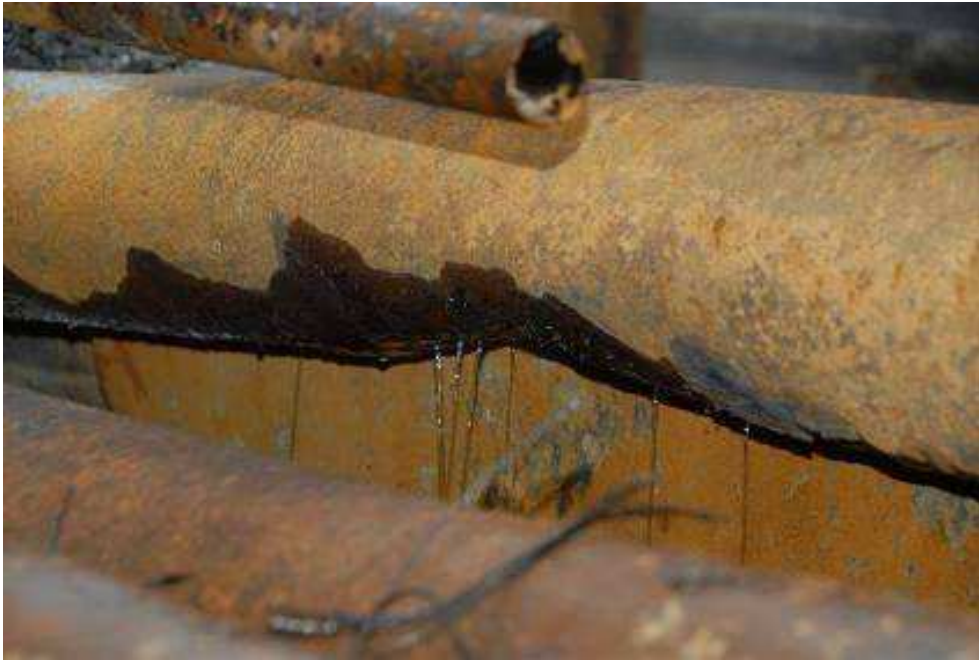
圖 2 製程管線外部腐蝕致使可燃性物質洩漏
