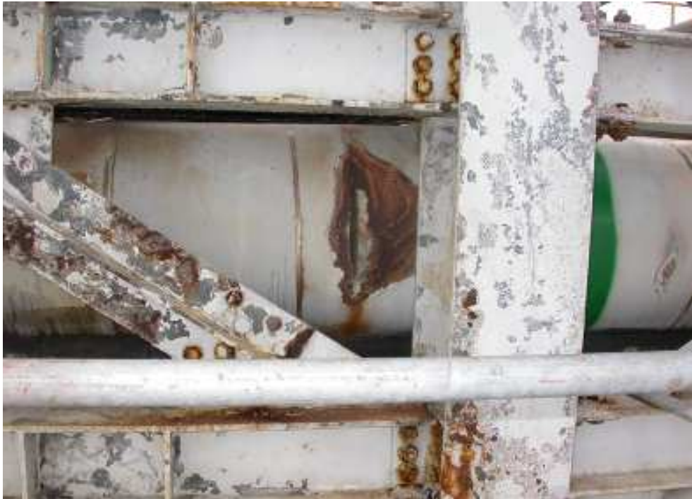
圖 4 絕熱被覆歷經風化及空氣鹽害等作用而破壞
