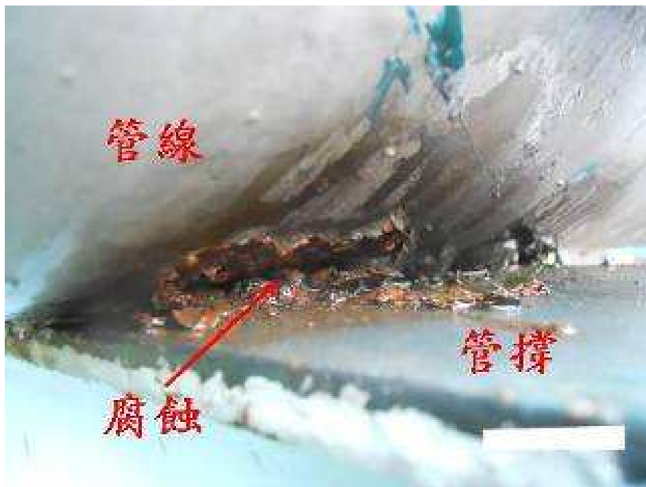
圖 7 管線和管支撐接觸點區域腐蝕
