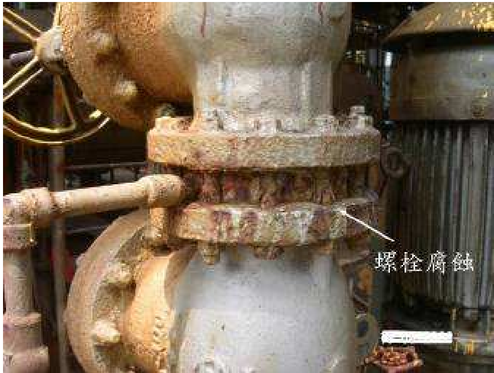
圖 5 管線法蘭螺栓腐蝕
