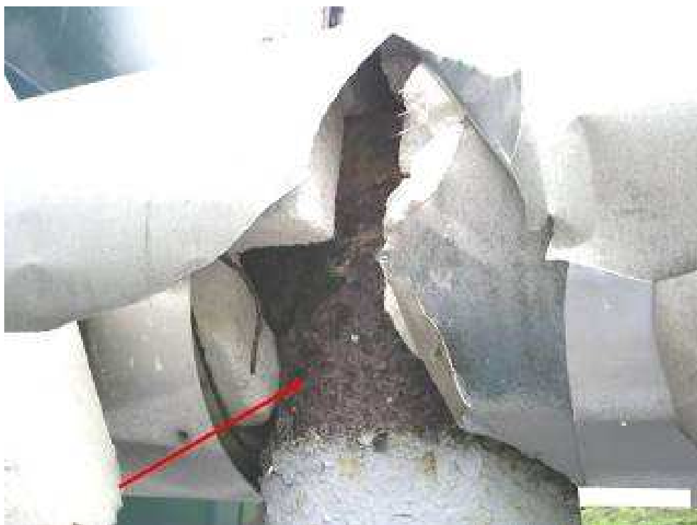
圖 9 包覆鋁皮脫落或界面防水不良，導致管線腐蝕
